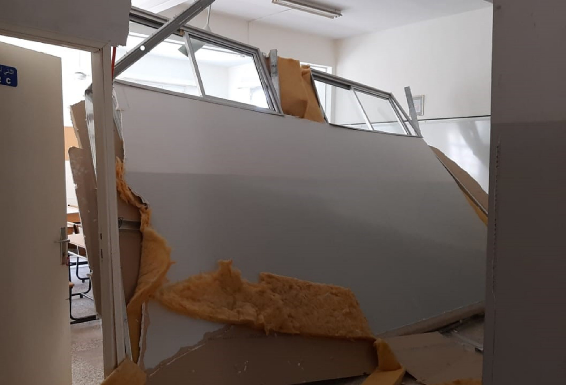
So sah es nach der Explosion im Schultrakt aus: die Wucht der Detonation hatte Wände eingedrückt, Fenster heraus- und Zwischendecken herabgerissen, elektrische Anlagen zerstört,...
